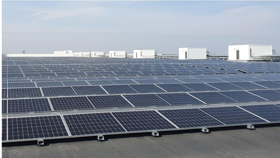
Figur 4 Solpaneler installerade på Dagab's logistikcenter i Bålsta.
